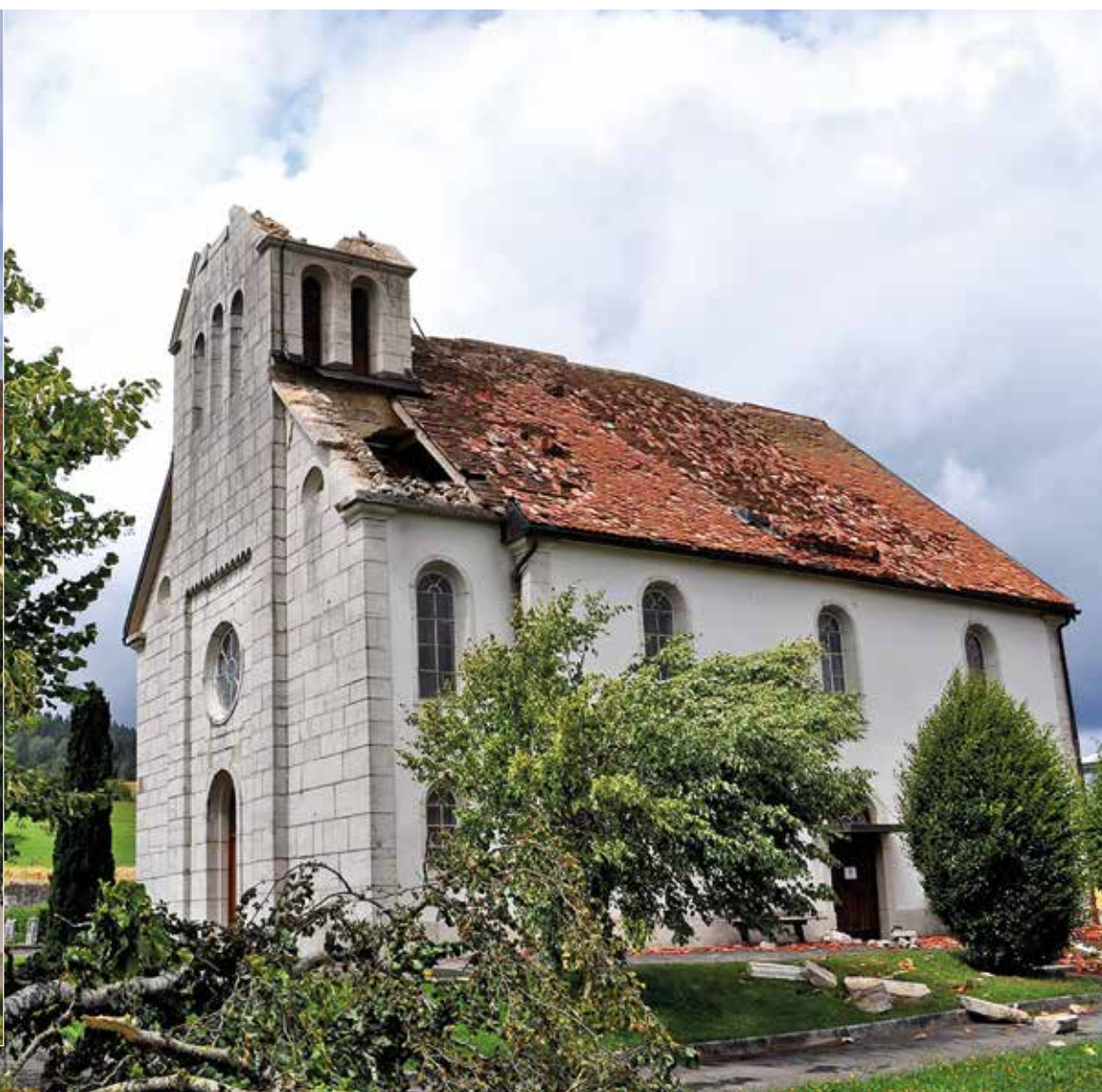
Une des images choc de la tempête du 24 juillet : le Temple des Eplatures décapité. Mais la crèche géante qu'il abritait a été miraculée. (Photo: gs)
