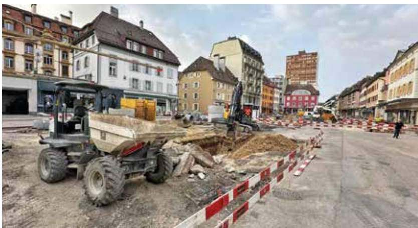
Pour le bien de la ville, un chantier géant tambour battant qui chauffe les réseaux. (gs)
