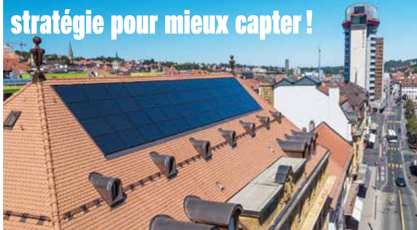
La centrale photovoltaïque sur la BCN de La Chaux-de-Fonds. (BCN)
